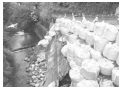
法面が水圧で押しつぶされ崩れたのは昨年7月3日
