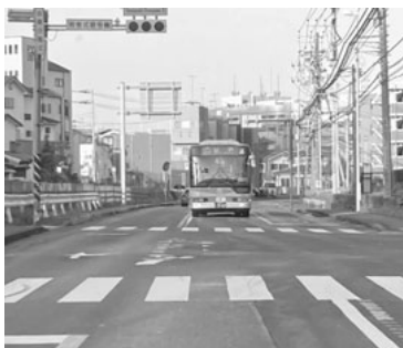
目違いの車道 山崎浄化センター前
